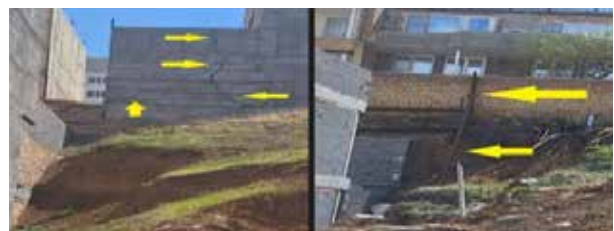
شکل ۵- ترک در دیوارها و نمونه مقاوم سازی پیشگیرانه
