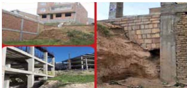
شکل ۶- وضعیت فشار جانبی خاک دیواره گود به ستون‌های طبقات ابتدایی ساختمان
