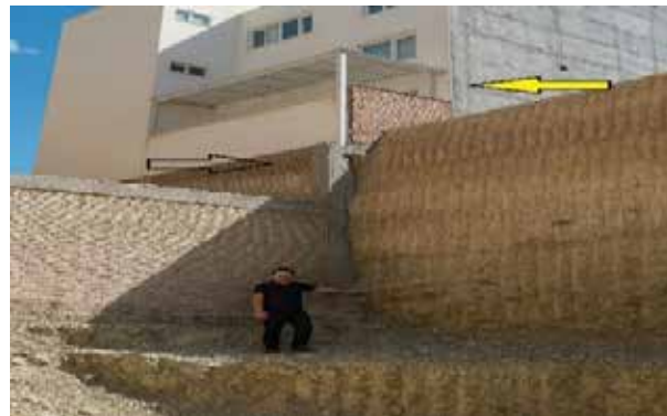
شکل ۴- وضعیت فاصله نزدیک ساختمان‌ها، سربار سازه‌ها و دیوار طره در بالای گود و ارتفاع دیواره گودبرداری خود ایستا در زمین شیب‌دار
