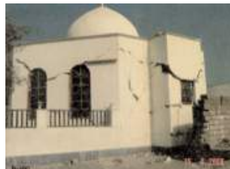
نمونه‌ای از ساختمان‌های تخریب شده در روستای گریه‌دان در جزیره قشم از زمین لرزه ۲۰ شهریور ۱۳۸۷
