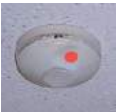
حسگرهای دود در سقف‌ها و راهروهای ساختمان‌ها
