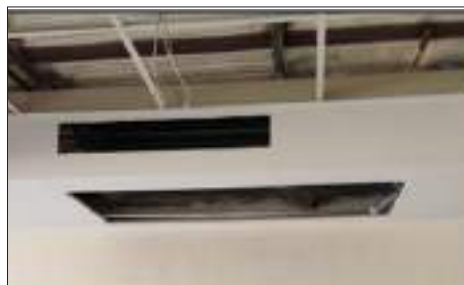
« اجرای سقف کاذب با سینی بلند و نامتناسب بودن دریچه های دسترسی و دهش دستگاه « و مکش»
