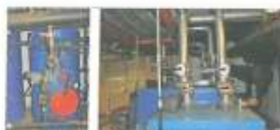
شکل ۲: الف) پوز کونی جاسی در اثر ارتعاش جاسی؛ ب) آسیب دیدگی تاسیسات مکانیکی در یک ساختمان در یک آزمایش زلزله؛ ج) آسیب دیدگی
