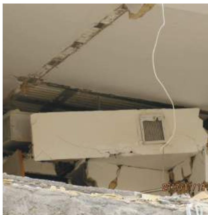
تصویر ۳۴- ریزش سقف کاذب سنگین
