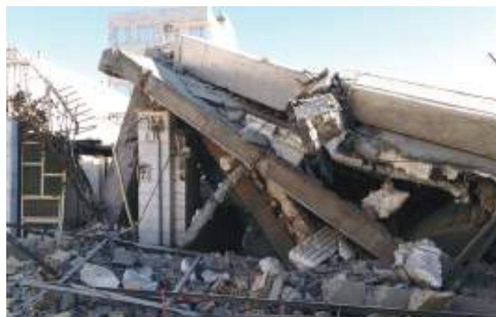
تصویر ۳: تخریب طبقات بالا به دلیل ضعف ستون‌ها در طبقات بالای همکف.
