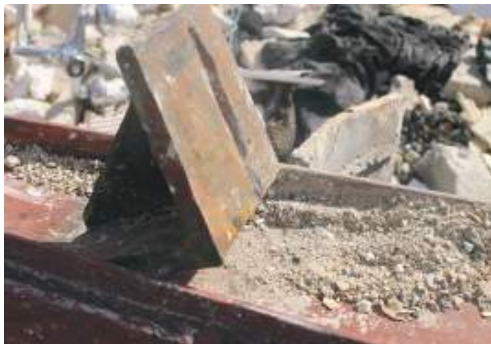
تصویر ۹- عدم نفوذ جوش در فولاد
