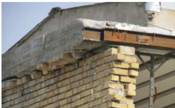
تصویر ۷- لغزش سقف بتنی روی دیوار مصالح بنایی فاقد کلاف عمودی
