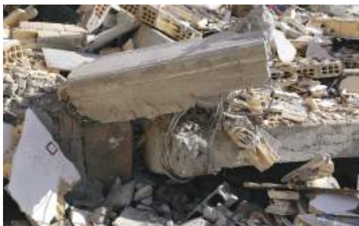
تصویر ۲۳- آرماتورگذاری طولی و عرضی ناکافی از عوامل تشدیدکننده آسیب
