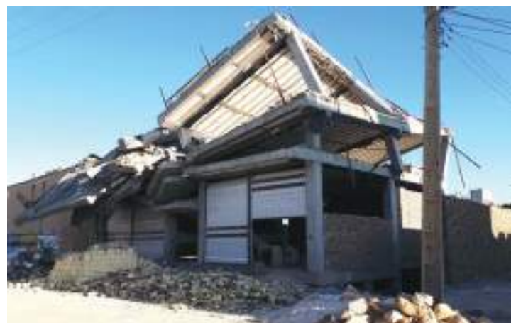
شکل ۵: تخریب محل اتصال ستون‌ها به سقف در یک سازه بتنی که منجر به فرو ریختن بخشی از سازه شده است.
