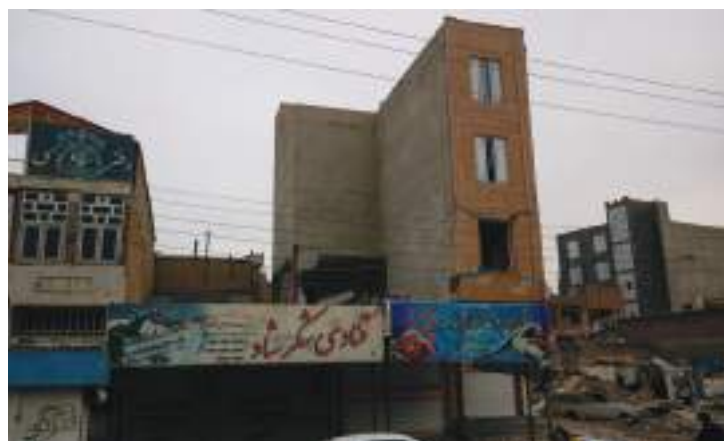
تصویر ۱۲- تشدید خرابی در سازه به دلیل نامنظمی ساختمان در پلان
