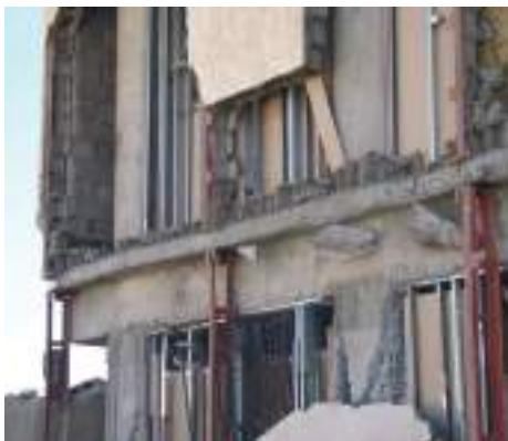
تصویر ۸: تخریب نمای جنوبی ساختمان و موقعیت ستونک‌های فولادی نگهدارنده نمای بنایی
