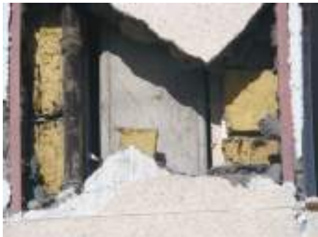
تصویر ۷: تخریب برشی نما و ترک خوردگی ستون بتنی در نمای جنوبی ساختمان
