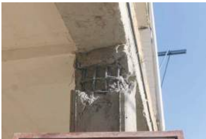
تصویر ۲۶- عدم رعایت خم ۱۳۵ درجه در خاموت و کماتش آرماتورهای طولی
