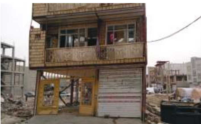
تصویر-۶ حذف مهاربند متقارن در جلو ساختمان به دلیل اجرای درب پارکینگ
