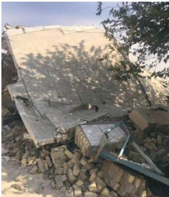
تصویر ۲- آسیب کلی سازه مصالح بنایی فاقد کلاف
