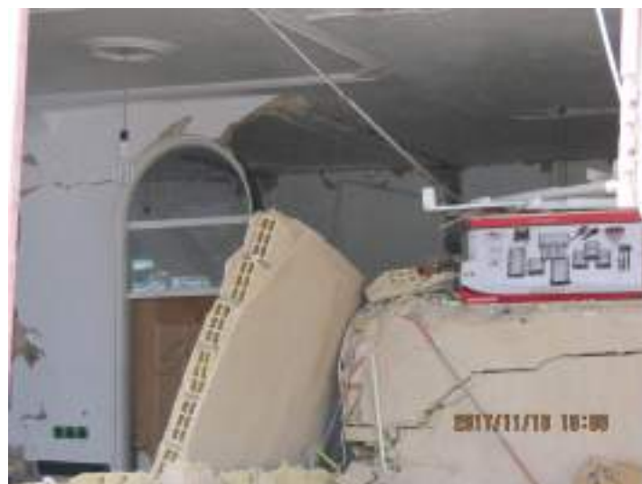
تصویر ۳۳- ریزش دیوارهای داخلی مهار نشده
