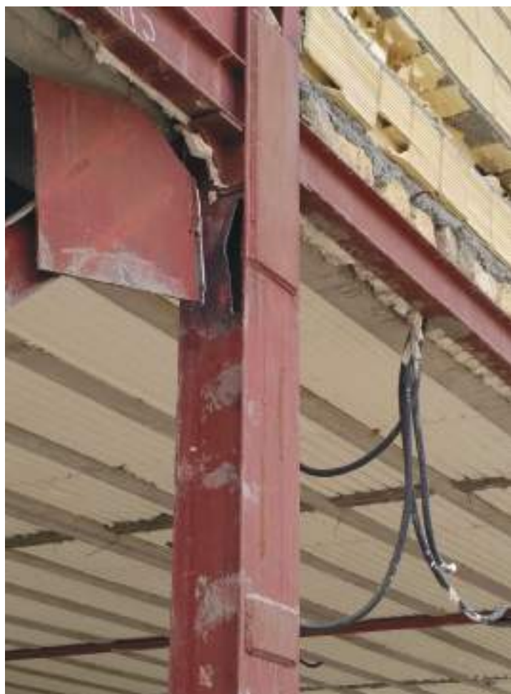
تصویر ۲۱- گسیختگی جان ستون در محل اتصال ورق بادبندی
