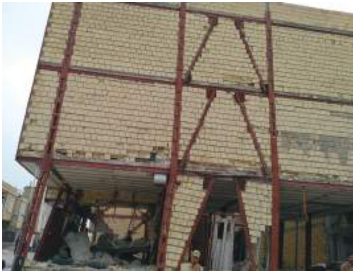
تصویر ۲۲- تغییر شکل جانبی زیاد سازه فولادی دارای مهاربندی غیرهم مرکز
