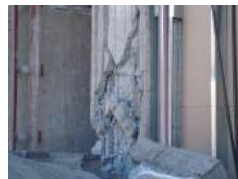
تصویر ۹: تخریب برشی ستون بتنی در نمای جنوبی ساختمان
