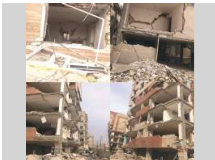
تصویر ۸- خرابی میان‌قاب‌ها به علت عدم رعایت جزئیات اجرایی
