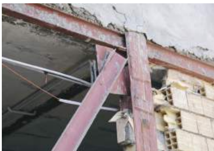
تصویر-۷ طول جوش ناکافی در اتصال گاست پلیت
