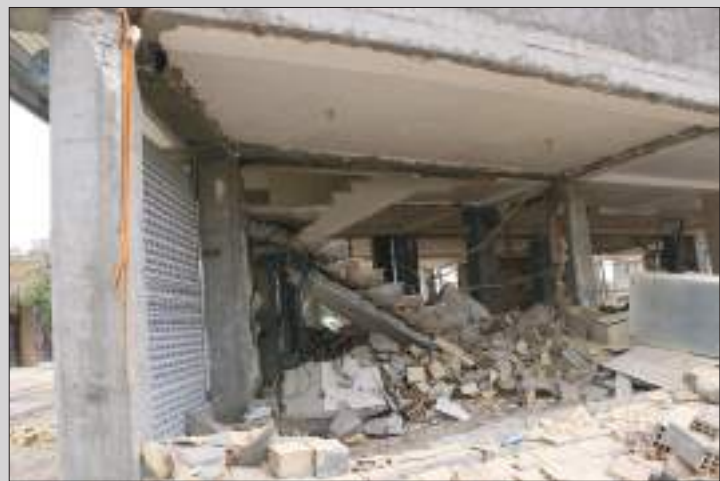
تصویر ۲۱: گسیختگی اتصال رمپ پله از پاگرد
