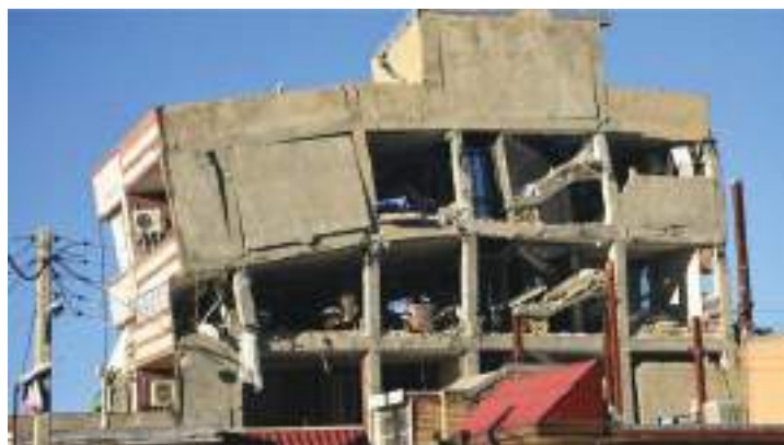
تصویر ۶: تخریب صددرصدی یک سازه فلزی غیراصولی.
