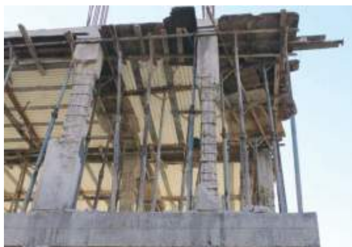
تصویر ۲۰- تخریب ستون به دلیل کیفیت بتن
