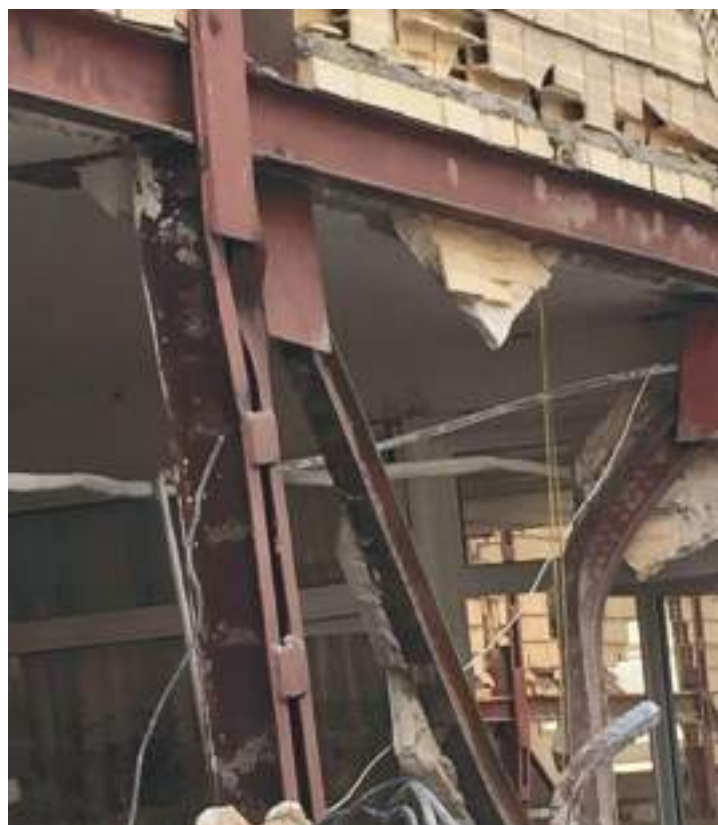
تصویر ۱۱- عملکرد نامناسب ستون‌های مشبک
