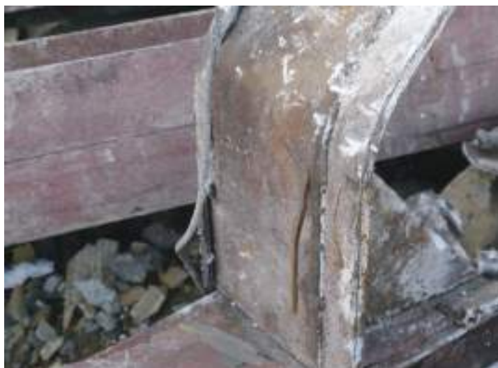
تصویر ۱۰- عدم نفوذ جوش در فولاد
