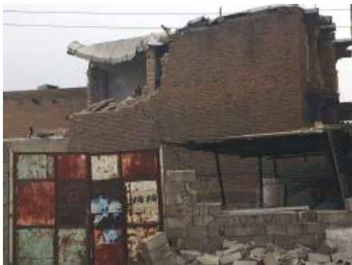
تصویر ۳- آسیب دیدگی زیاد سازه مصالح بنایی بدون کلاف
