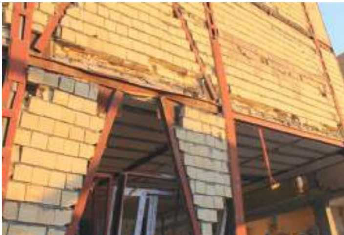
تصویر ۱۳- ابعاد و اجرای اشتباه تیر پیوند
