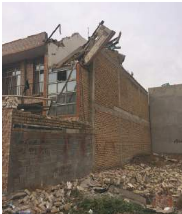
تصویر ۶- آسیب دیدگی راه پله سازه مصالح بنایی دارای کلاف افقی و عمودی
