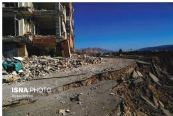
تصویر ۲: فرو ریختن سازه بتنی و ضعف در کل سازه.
