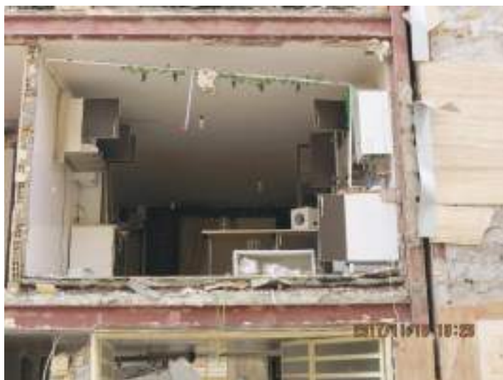
تصویر ۳۵- ریزش دیوار پیرامونی، سقوط وسایل به داخل و پرتاب وسایل به خارج
