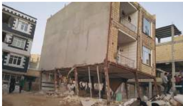
تصویر ۱۶- تغییر شکل جانبی زیاد سازه فولادی در جهت قاب های صلب
