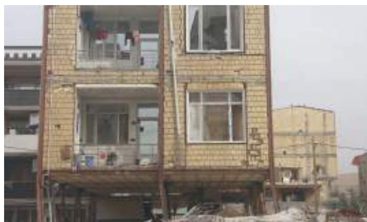
تصویر ۱۳- قاب صلب خمشی و طبقه نرم باعث تغییر شکل زیاد سازه شده است
