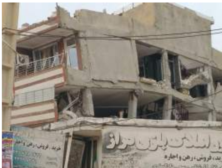
تصویر ۲۶- مفصل پلاستیک در ناحیه اتصال و روی ستون‌ها به وجود آمده است
