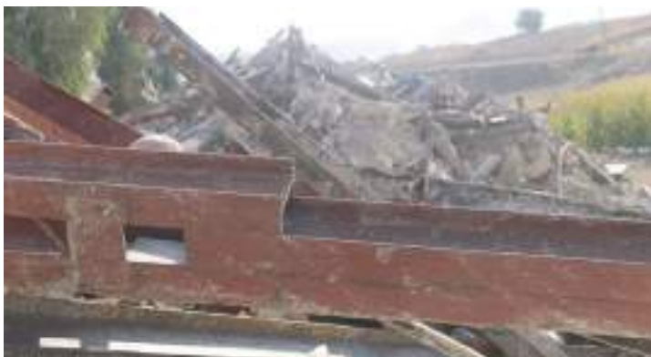
تصویر ۱۵ - جزئیات نادرست وصله ستون
