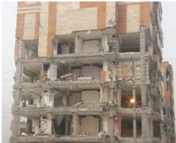
تصویر ۳۱- ریزش دیوارهای پیرامونی به علت مهار نشدن
