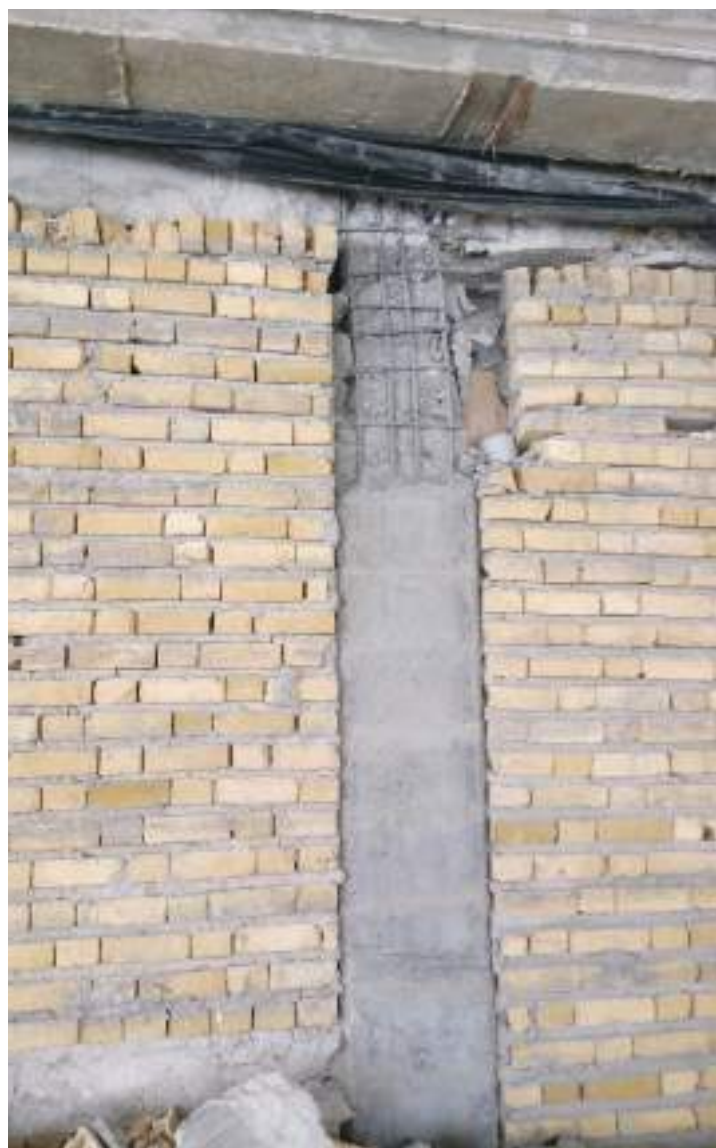
تصویر ۱۹- تخریب ستون به دلیل کیفیت بتن
