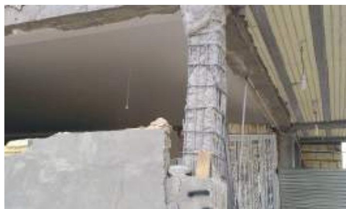
تصویر ۲۴- مقاومت کم ستون بتنی به علت کیفیت نامناسب بتن
