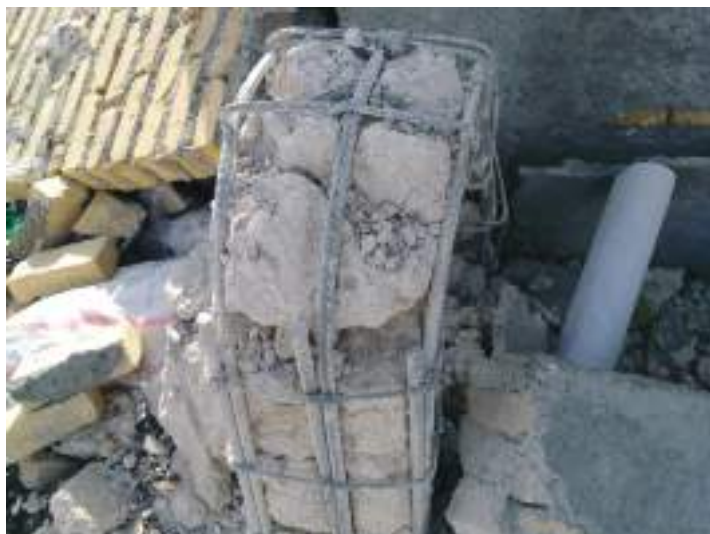
تصویر ۲۷- کیفیت نامناسب بتن و درصد بالای خاک در بتن قابل مشاهده است
