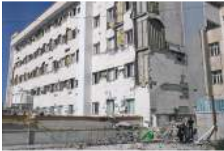
تصویر ۶: تخریب برشی نما و ستون بتنی در نمای شمالی ساختمان
