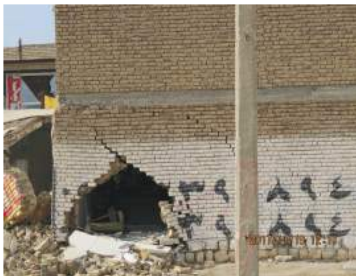
تصویر ۸- شکست برشی سازه مصالح بنایی دارای کلاف افقی
