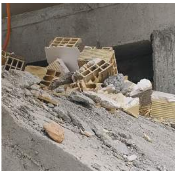
تصویر ۲۸- جداشدگی کامل کنسول‌های سازه بتنی فاقد اتصال مناسب به ستون
