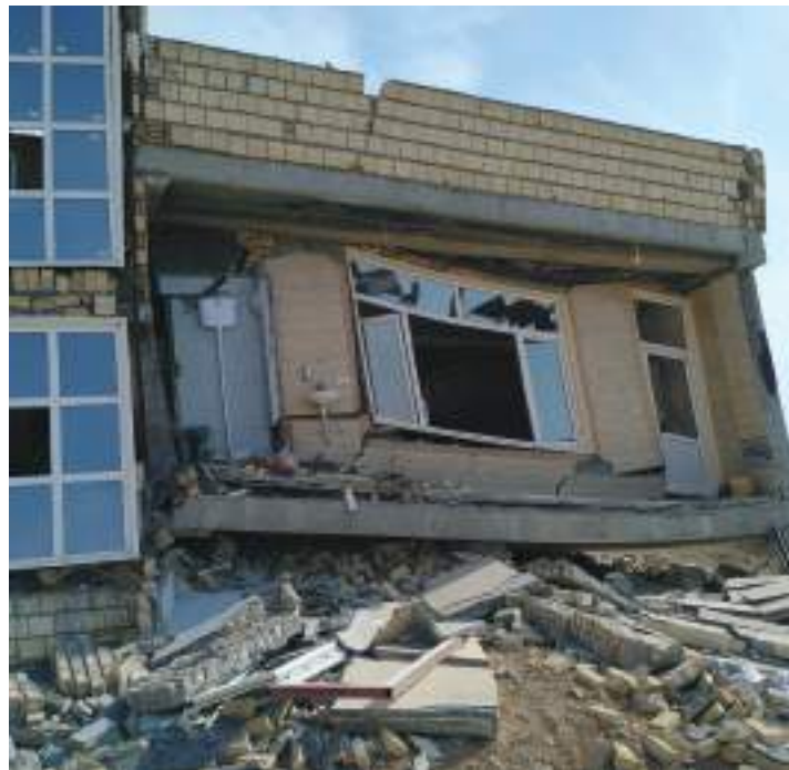
تصویر ۲۹- گسیختگی طبقه نرم
