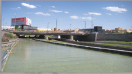
پل جانبازان تبریز - ترمیم و تقویت تیرهای بتنی با FRP به دلیل از بین رفتن میلگردها در اثر برخورد وسایل نقلیه
