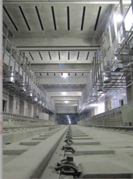
مترو شیراز - تقویت تیرها و دالهای سقف ایستگاه مترو با FRP برای افزایش ظرفیت باربری سقف
