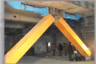
هتل بزرگ آزادی تهران کاربرد میراگرهای هیدرولیک (Viscouse Dampers) برای جذب انرژی جانبی با همکاری شرکت FIP (ایتالیا)
